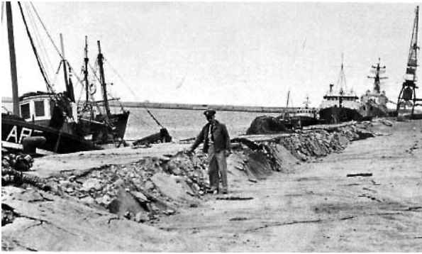
Photo 83. Affaissement du remblai le long du mur du quai nord (U.S.Navy).
