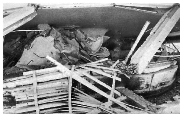
Photo 75. Détail de l'effondrement, montrant comment les colonnes ont traversé le système de plancher.
