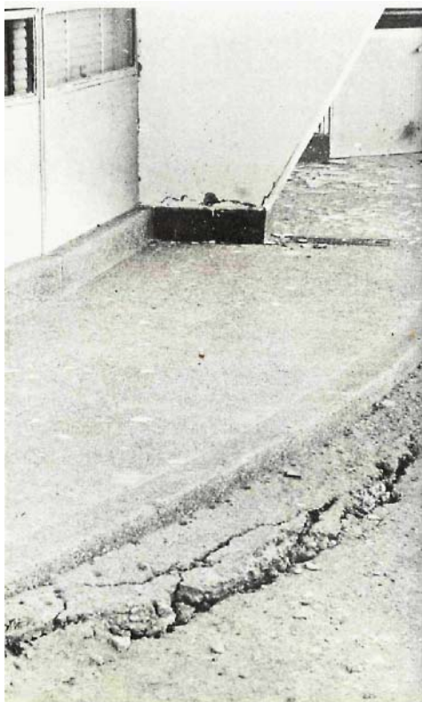
Photo 78. Faille à la base d'une colonne du Bureau des Douanes ; noter le tassement du sol relativement à la construction.
