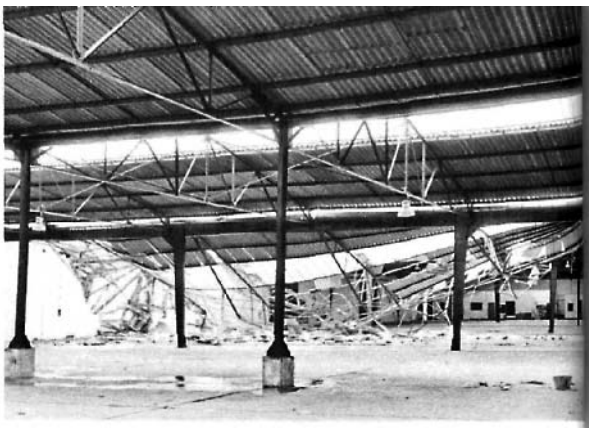
Photo 90. Intérieur d'un entrepôt écrasé par une grue (U.S.Navy).
