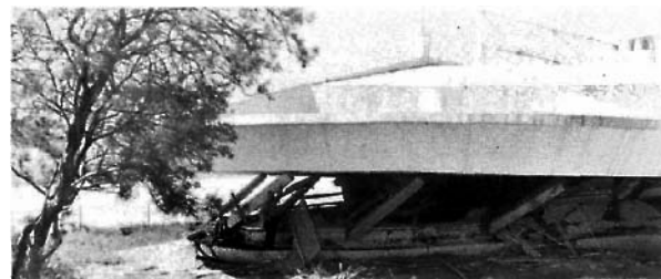
Photo 74. Vue générale du Restaurant « La Réserve » effondrée.
