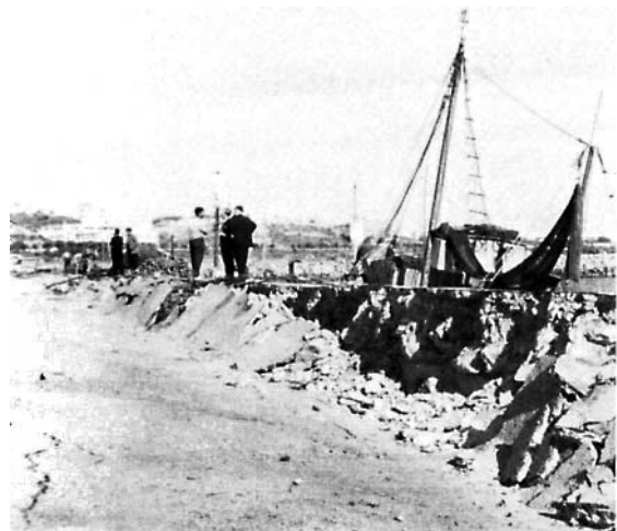
Photo 82. Affaissement du remblai le long du mur du quai nord (U.S.Navy).
