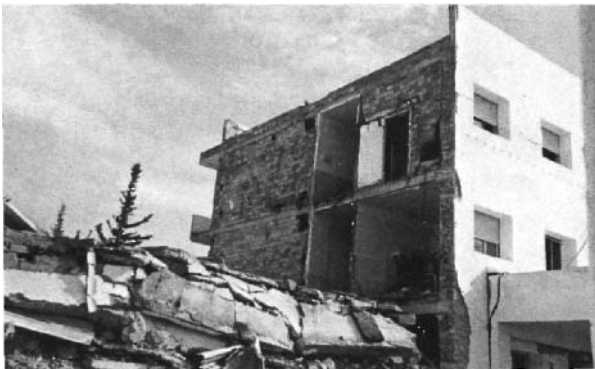
Photo 28. Plan rapproché de l'effondrement; à noter le manque de raccordement avec le bâtiment contigu
