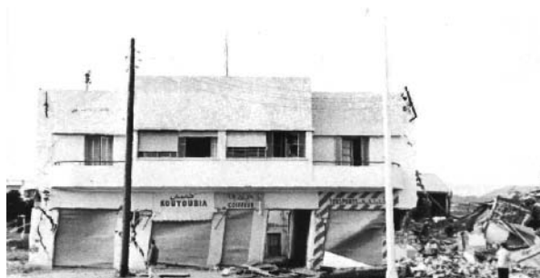
Photo 35. Dégradation du rez-de-chaussée des bâtiments
