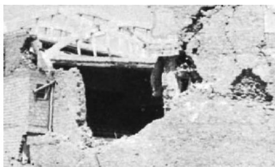
Photo 37. Le système du toit du cinéma Le Rialto endommagé par l'effondrement des murs porteurs en maçonnerie
