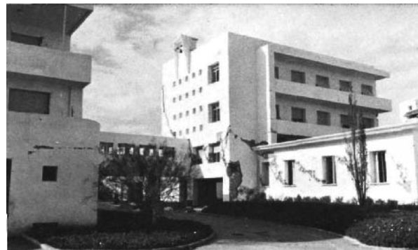
Photo 25. Vue Générale de l'Hôpital Lyautey; à noter les fissures en diagonale dans la maçonnerie
