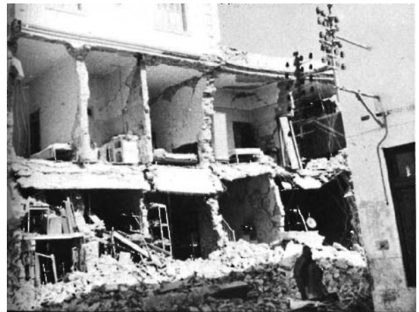
Photo 20. Défaillance typique de la construction en maçonnerie, Talbordjt
