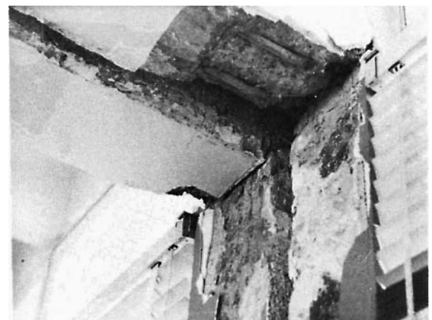
Photo 56. Fracture de la jointure poutre-colonne, intérieur de l'arrière du bâtiment des Services Municipaux.
