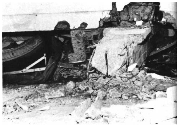
Photo 47. Détail à l'Hôtel Saada, notez l'absence de lien entre les éléments
