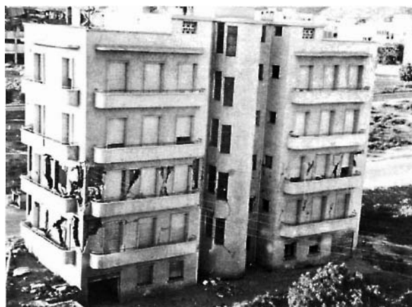
Photo 69. La Fracture des murs de remplissage révèle la structure en béton armé.
