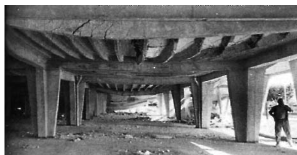
Photo 66. Dommages au système de plancher du 1er étage du marché résultant de l'effondrement du toit.
