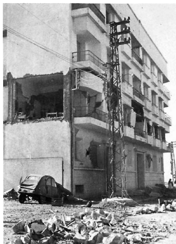
Photo 70. La structure en béton armé supporte la charge en dépit des dommages de la maçonnerie.
