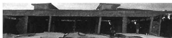
Photo 65. Premier étage du bâtiment du Marché, 2 sections se sont effondrées, la 3ème restant debout.
