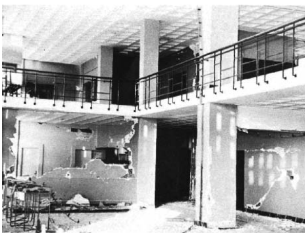
Photo 54. Services Municipaux, Dégâts des carreaux de cloison.
