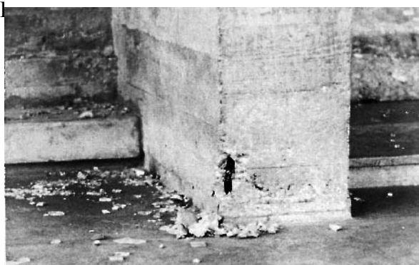
Photo 59. Fléchissement du renforcement à la base de la colonne, façade extérieure des Services Municipaux
