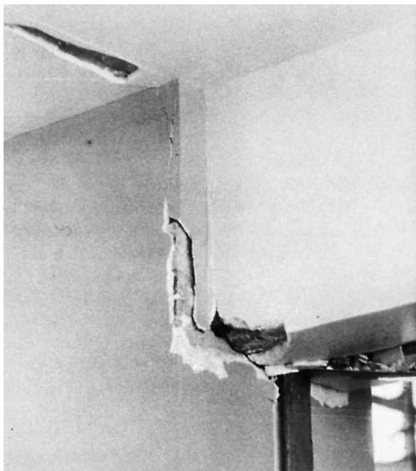
Photo 58. Fracture de la jointure sur une colonne intérieure.
