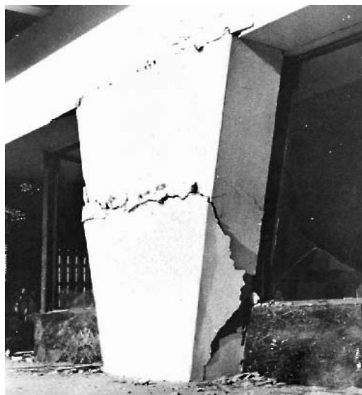
Photo 61. Immeuble La Paternelle, détail de la fracture de la colonne
