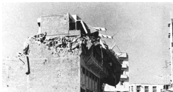
Photo 50. Sud-Building vu du Sud-Ouest, notez comment 2ème étage s'est effondré vers la droite (SE)
