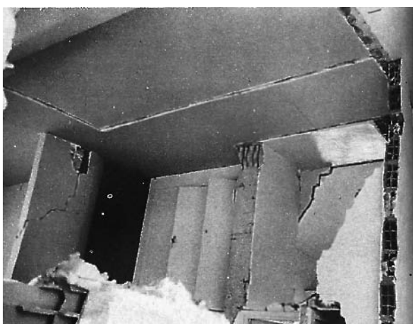
Photo 63. Intérieur du premier étage de l'immeuble La Paternelle. Dégâts sur la cloison
