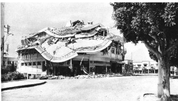
Photo 49. Sud-Building vu du sud-est, le 2ème étage s'est effondré
